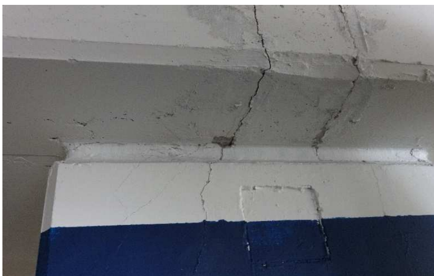
Rys. 18. Widoczne zarysowanie głowicy słupa. Rysy na przedłużeniu końców dźwigarów prefabrykowanych, oraz pomniejsze zarysowania otuliny, [źródło własne]
