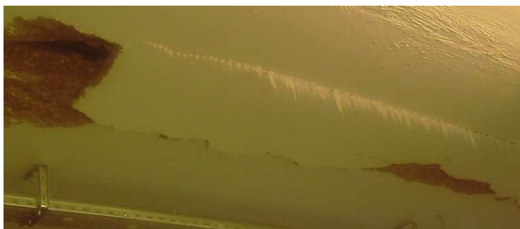
Rys. 7. Rozsadzona przez zamarzniętą wodę płyta kanałowa, [źródło własne]
