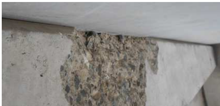
Rys. 13. Odspojenie otuliny w wyniku bezpośredniego oparcia płyty na wsporniku, [źródło własne]
