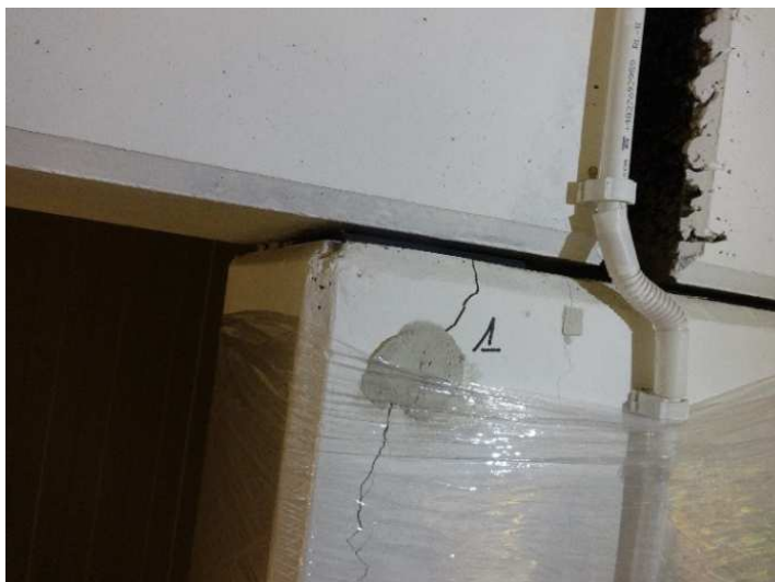
Rys. 16. Widoczne zarysowanie głowicy słupa. Rysa w okolicy środka oparcia dźwigara i mniejsze w okolicy środka szerokości słupa, [źródło własne]
