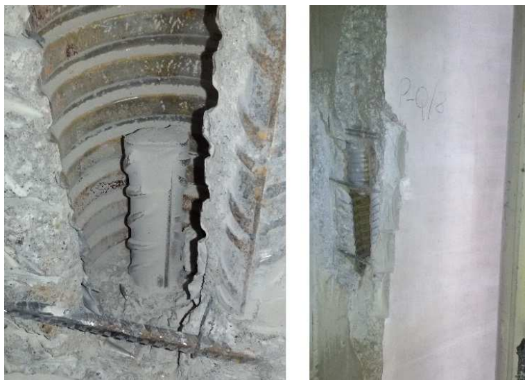
Rys. 5. Rozsadzenie narożnika słupa przez zamarznąłą wodę: po lewej – niekompletnie wypełniona rura robusta, po prawej – uszkodzony narożnik słupa, [źródło własne]
